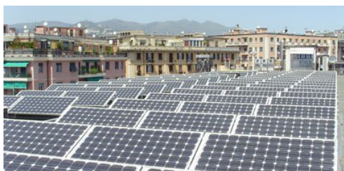
Pannelli fotovoltaici sul tetto della sede di Via Cesare Battisti
